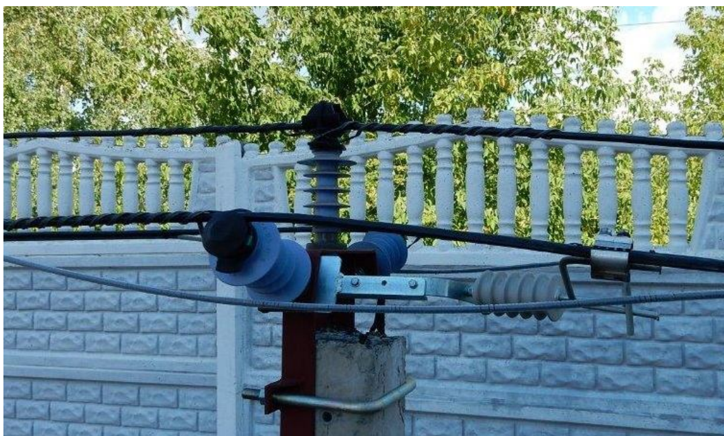
Рис.16. Вариант исполнения поддерживающего крепления провода СИП-3/ВОК на траверсах ТВИ 12,5/10, на стойках СВ, с использованием изоляторов ОЛСК 12,5-10-А(Б)-4, с устройством защиты от перенапряжений УЗПН-10-ЛК.
